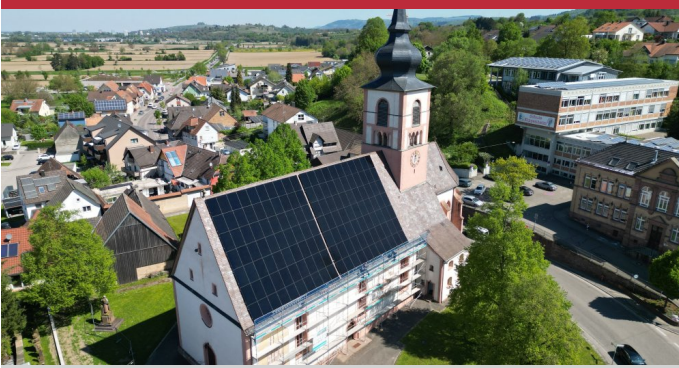
Auf die Kirche in der Schwarzwald-Gemeinde Kippenheim hat KSE Energie eine Solaranlage installieren lassen.
